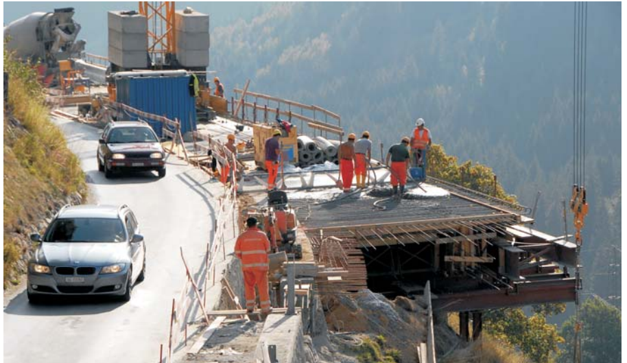
Betonieren einer Brückentappe unter Verkehr. Ina etappa da la punt vegn betunada cun traffic.
